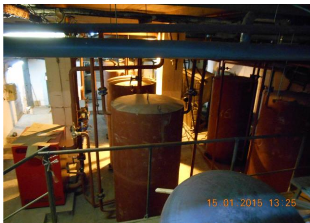
Рис. 13.1. Модернізація системи опалення будівлі підприємства (котли)
