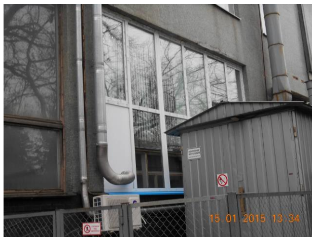
Рис. 13.8. Проведено заміну старих дерев'яних вікон на металопластикові енергозберігаючі в приміщеннях 1, 2 поверхів двоповерхової лабораторної прибудови (приміщення газоаналітичного комплексу та офісні приміщення персоналу випробувального центру)
