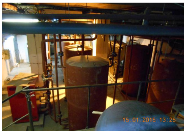
Рис. 13.1. Модернізація системи опалення будівлі підприємства (котли)
